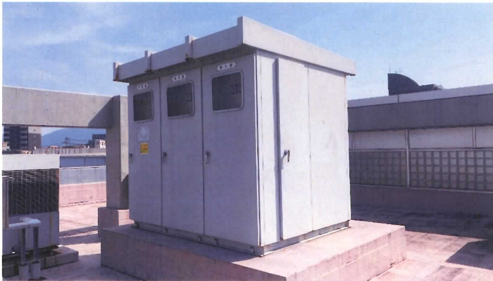
高圧受変電設備（本館屋上）
